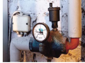
Manómetro conectado a una tubería.
